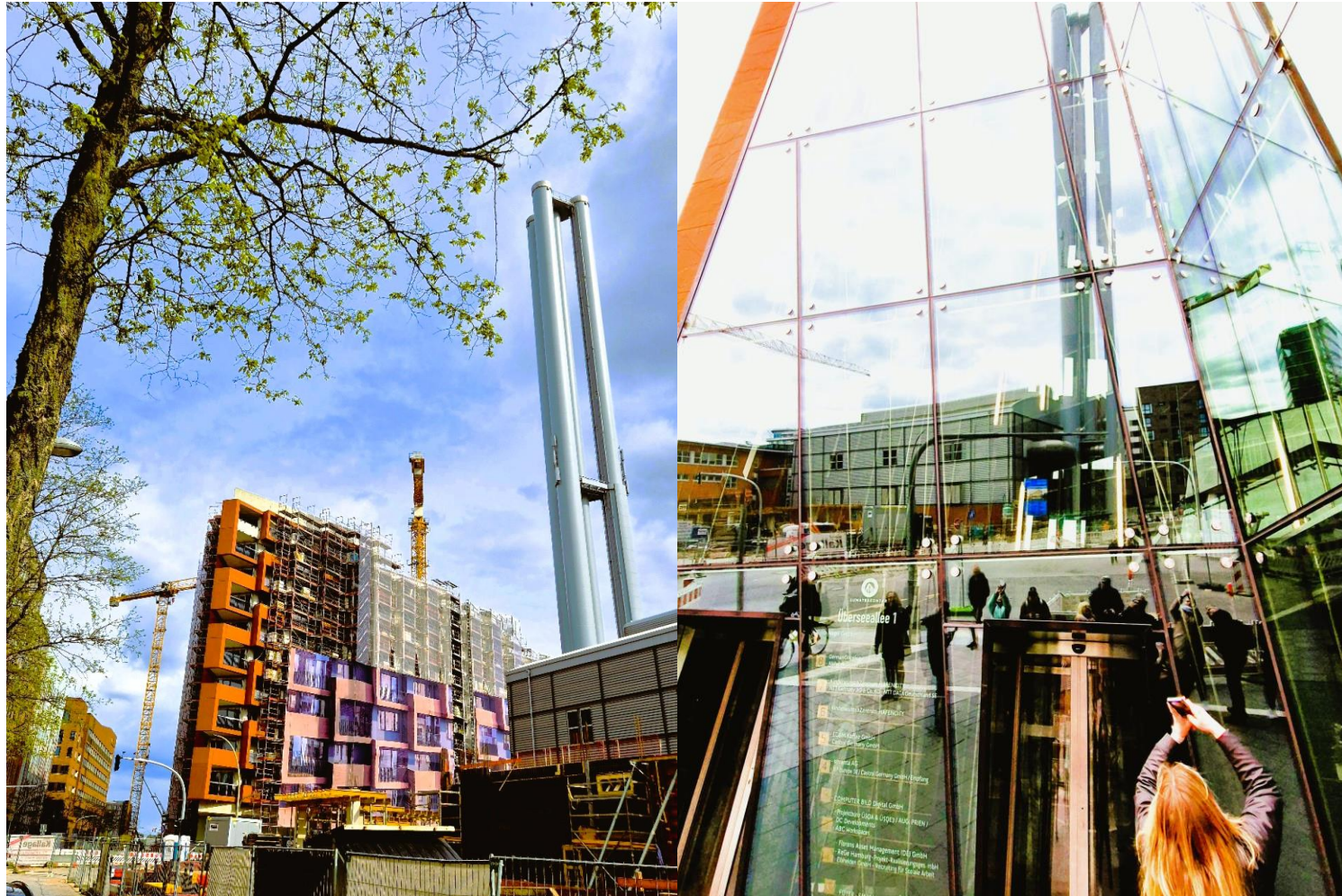
Gaskraftwert in HH. Die Fernwärmekunden selbst können Ihre Wärmekosten deutlich absenken!
